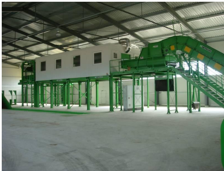
Atkritumu pārkraušanas, šķirošanas stacija Dienvidu ielā 1, Tukumā. Līnija, kura atkārtoti pāršķiro dalītos atkritumus un tos presē.
