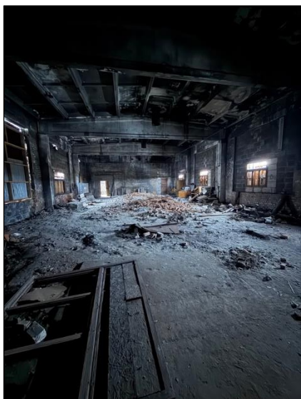
1.stāvs. Katlu telpa, telpa nr.2
