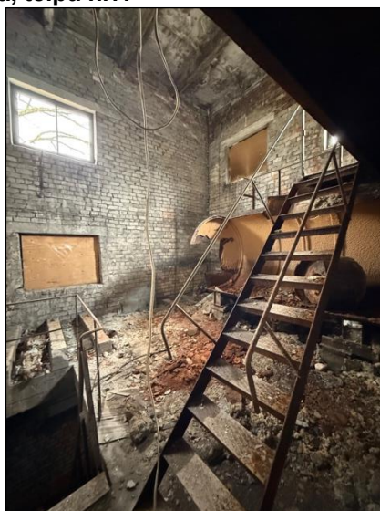
2.stāvs. Sūkņu telpa, telpa nr.10
