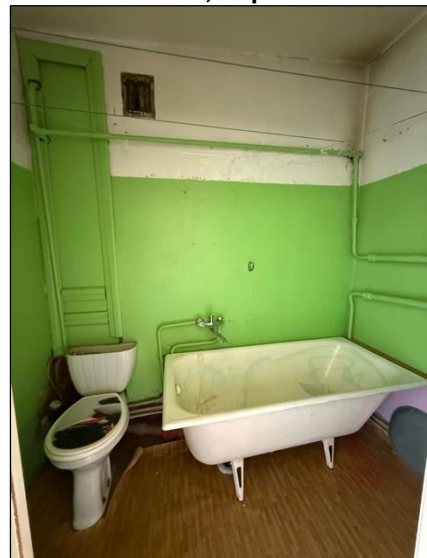
Sanitārtehniskā telpa, telpa nr.4
