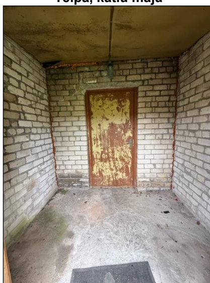
Telpa, katlu mājā
