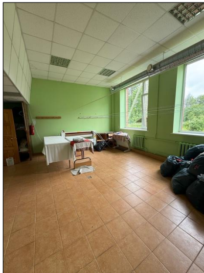
Telpa, katlu mājā
