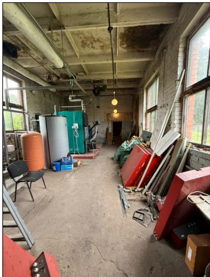
Telpa, katlu mājā
