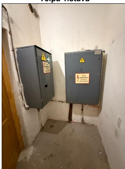
Elektrības skapju telpa 1.stāvā
