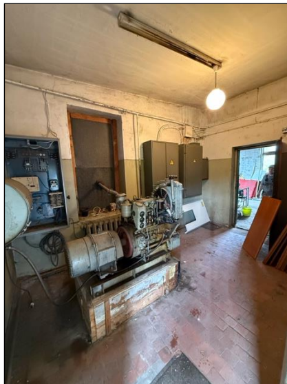
Telpa, katlu mājā
