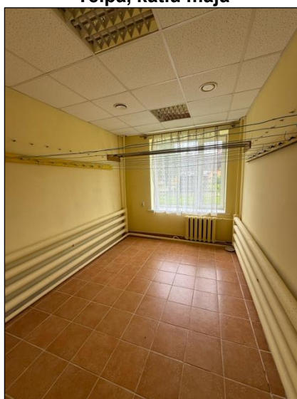
Telpa, katlu mājā
